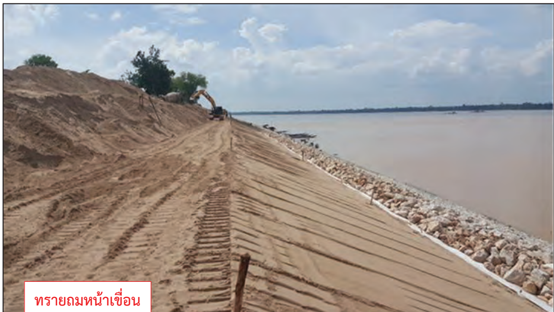
รูปที่ ๒.๓๘ ตำแหน่งของทราয়ถมหน้าเขื่อนฯ และหลังเขื่อนฯ
