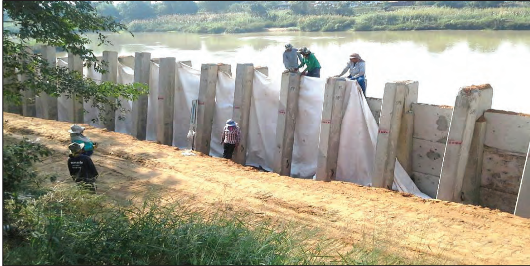
รูปที่ ๔.๕๙ รูปแสดงนำแผ่นใยสังเคราะห์ (วัสดุกรอง) ติดตั้งบริเวณหลังเขื่อน
