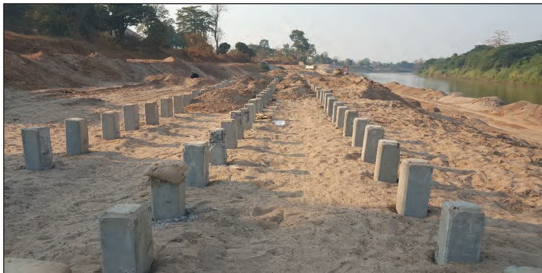
รูปที่ ๒.๒ เขื่อนป้องกันตลิ่งแบบถมทรายเรียงหินหน้าเขื่อนและมีเสาเข็มเสริมกำลังดิน
