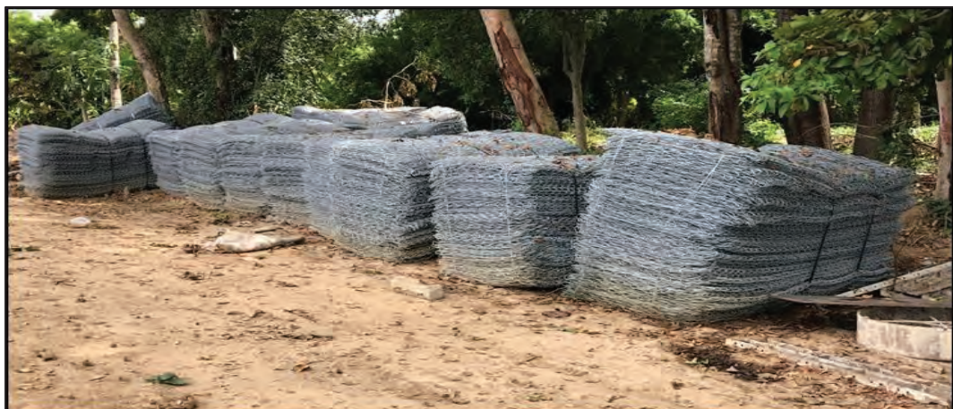
รูปที่ ๔.๖๗ รูปแสดงนำกล่องลวดตาข่ายแมทเทรสเข้ากองสถานที่ก่อสร้าง
