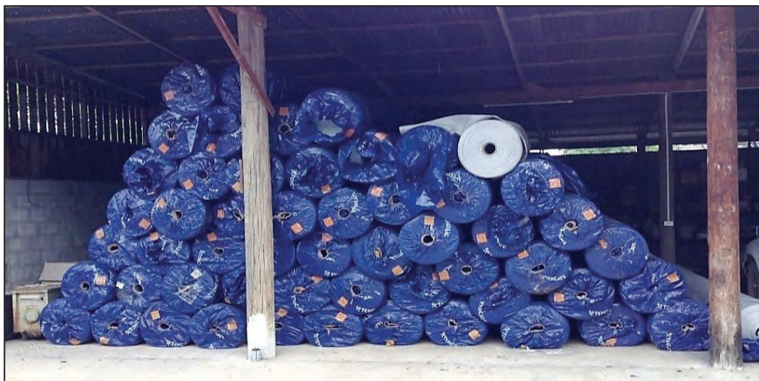
รูปที่ ๔.๕๔ รูปแสดงนำแผ่นใยสังเคราะห์ (วัสดุกรอง) เข้ากองสถานที่ก่อสร้าง
