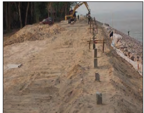
รูปที่ ๒.๒๑.๓ ตำแหน่งเสาเข็มเมื่อตอกแล้วเสร็จ
