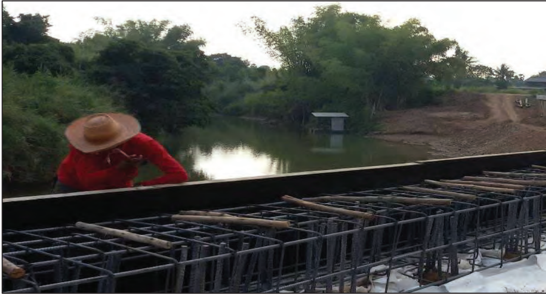
รูปที่ ๔.๗ การเสริมเหล็กคานรัดหัวเสาเข็ม
