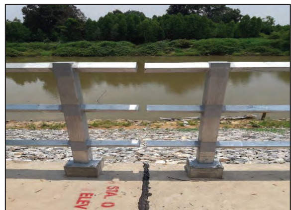
รูปที่ ๒.๒๗.๒ การติดตั้งราวกันตกระหว่างจุดตัด ของคาน
